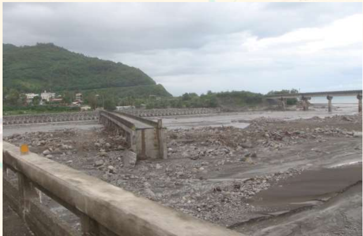
▲太麻里出海口橋斷並堆滿沙石樹枝
